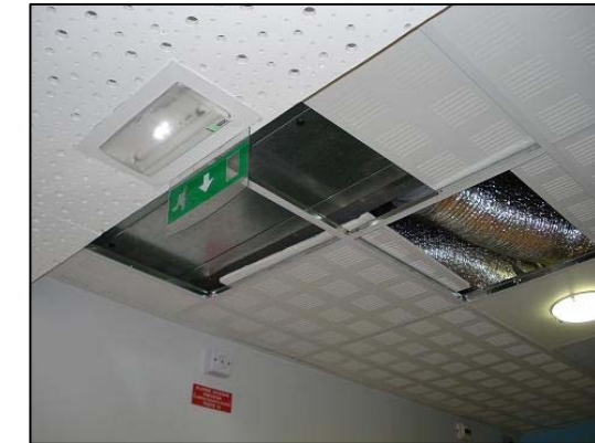
FIGURA 32 – Dutos sobre o forro Fonte: Elaborado pela autora em 2008.
