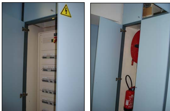
FIGURA 24 – Armário técnico para a distribuição de energia e para armazenar mangueiras de incêndio Fonte: Elaborado pela autora em 2008.
