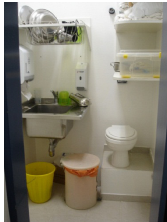
Figura 151 – Sala de utilidades com tanque de despejo (vaso) e tanque normal Fonte: o autor, 2008.
