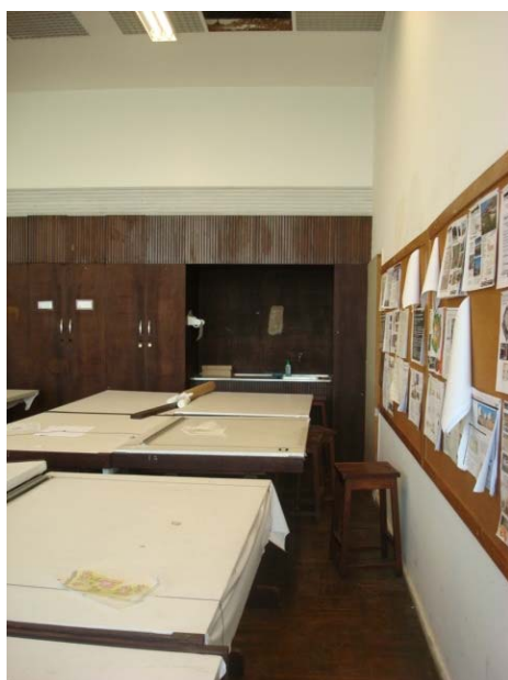
Figura 91 – Estado de conservação da sala 423
