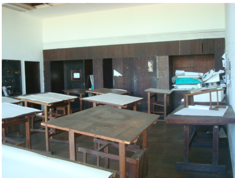
Figura 9 – Estado de conservação da sala 423
