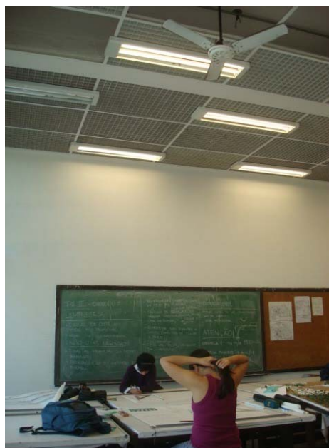
Figura 92 - Estado de conservação da sala 423
