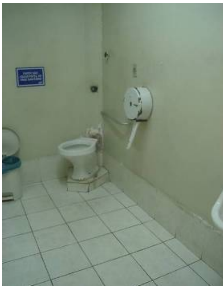
Figura 19: Banheiro (Autor, março/2009)
