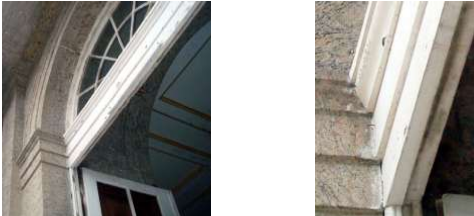
Figura 285: Acabamento na aduela e bandeira (esq.) e em detalhe (dir.) Hospício de Pedro II. Fonte: Fotos de Marisa Hoirisch, 2012.
