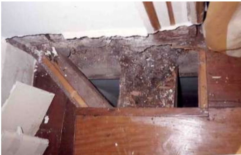
Figura 163: Estrutura de tabeira e piso, Salão Dourado. Fonte: Foto de Marisa Hoirisch, 1996.
