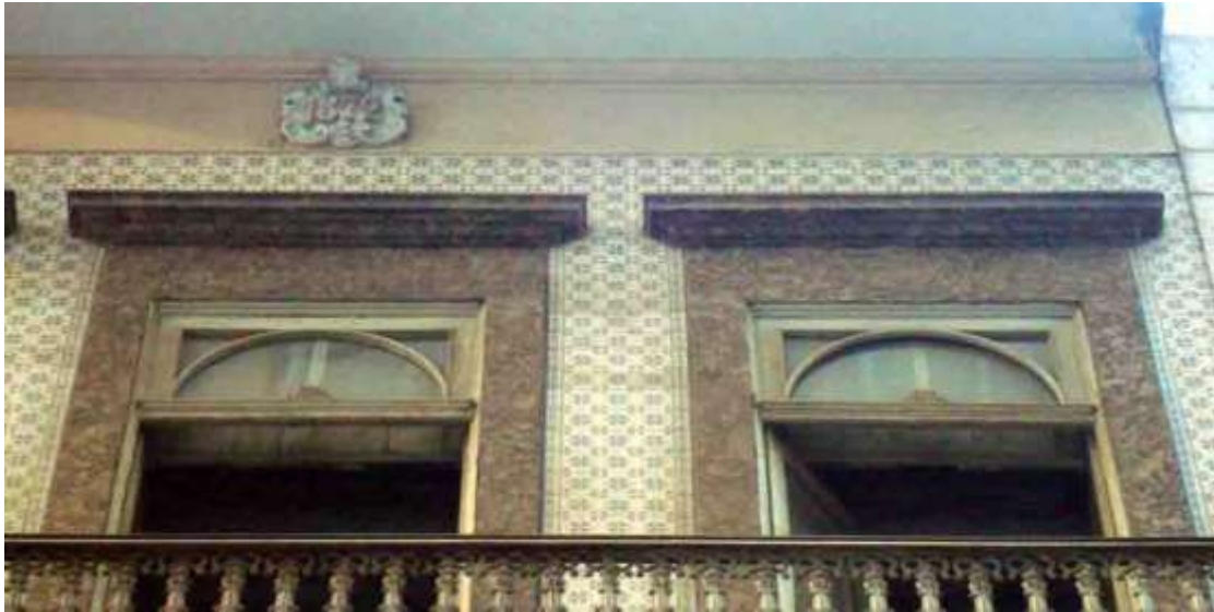
Figura 129: Azulejos, fachada, Sobrado na Rua da Quitanda, n° 61. Fonte: Foto de Marisa Hoirisch, 2012.
