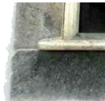
Figura 76: União de ombreira e peitoril, Marquesa de Santos, Fonte: Foto de Marisa Hoirisch, 2012.
