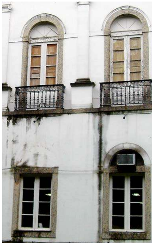
Figura 213: Janelas de sacadas e peitoris, Hospício de Pedro II. Fonte: Foto de Marisa Hoirsch, 2012.
