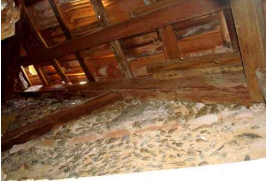
Figura 101: Parede em pedra argamassada com tijolos, Palacete do Conde de Itamaraty. Fonte: Foto de Marisa Hoirisch, 2012.
