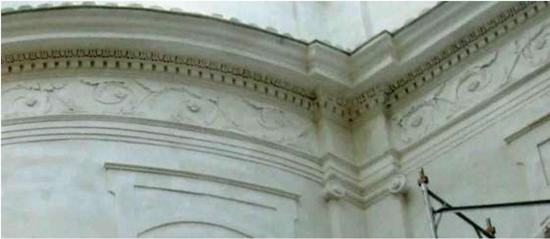
Figura 115: Fachada com ornatos em argamassa, Solar da Marquesa de Santos. Fonte: Foto de Marisa Hoirisch, 2012.
