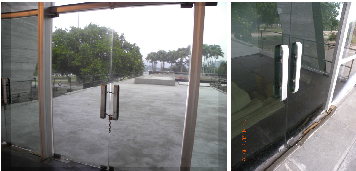
Figura 87 – Saída para o terraço trancada Fotos: Alvaro Costa, 2012.
