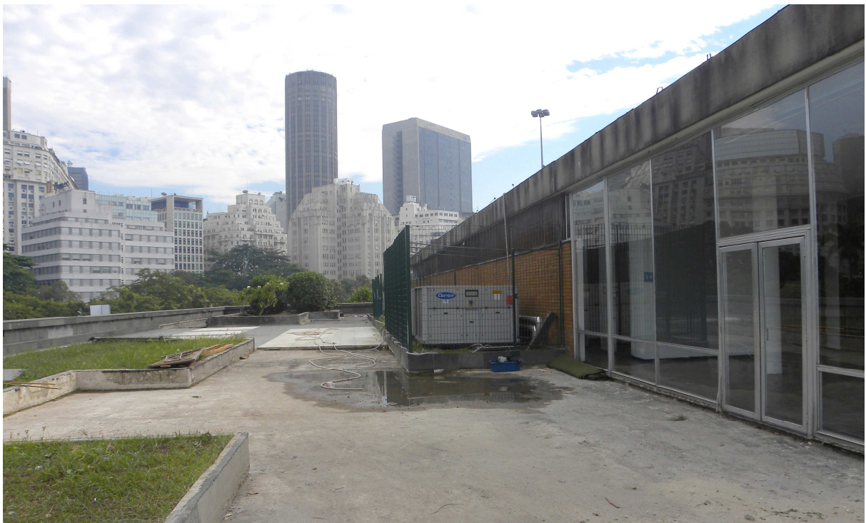
Figura 84 – Área do terraço - Estado de conservação precário Foto: Alvaro Costa, 2012.
