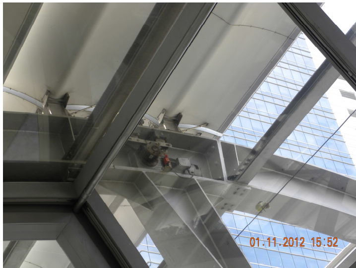
Figura 132 – Detalhe da estrutura da cobertura – Motor que movimenta os painéis Foto: Alvaro Costa, nov. 2012.
