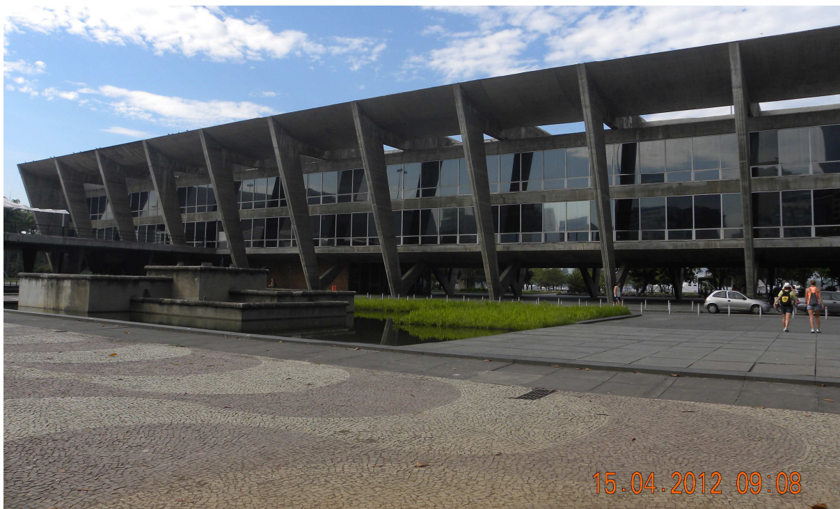
Figura 88 – Área na frente do Museu e do Teatro – Estado de conservação precário Foto: Alvaro Costa, 2012.
