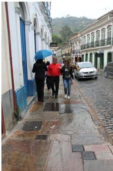
Figura 58 - Percurso A. L. – Detalhe para as tampas de caixa na Rua São José. Nesse local elas não possuem buracos ou frestas, mas estão molhadas e devido ao material de que são feitas, pode levar o passante ao tombo.
