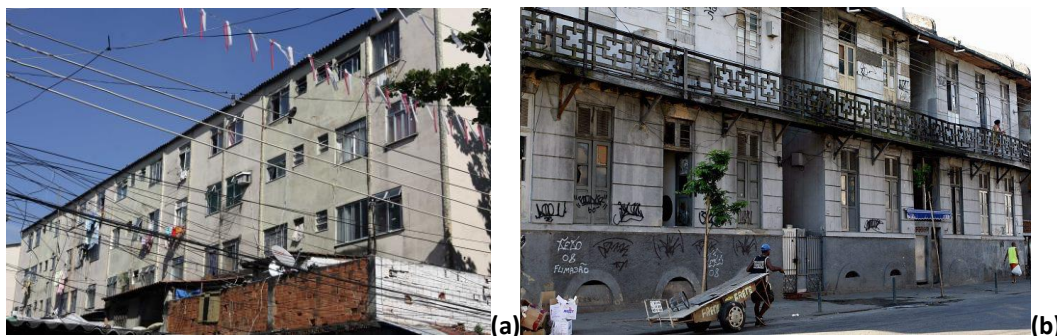
Figuras 57 (a-b). Degradação e favelização em diversos conjuntos residenciais espalhados por toda cidade do Rio de Janeiro: (a) Conjunto Habitacional Água Branca, Realengo; (b) Vila Operária Salvador de Sá, Estácio.
