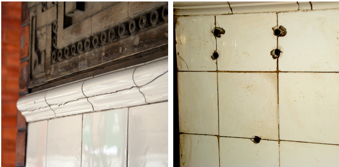
Figuras 32 e 33- Detalhe do estado de conservação anterior à intervenção, fotos de perto mostrando de forma clara a deterioração verificada.
