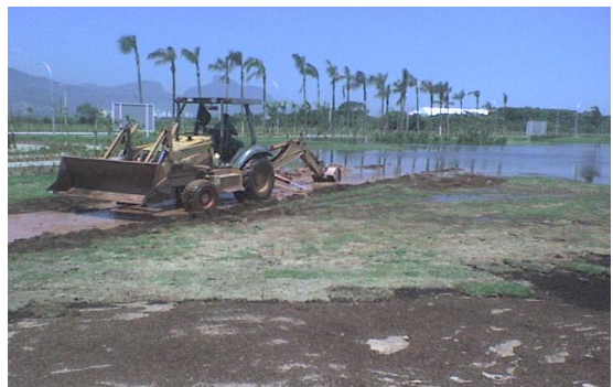
Fig. 89: Panorama parcial da ausência de drenagem no solo provocando alagamento nas áreas verdes do Condomínio Cidade Jardim, cuja implantação foi realizada sobre área alagada. Ano: 2009 Acervo da autora
