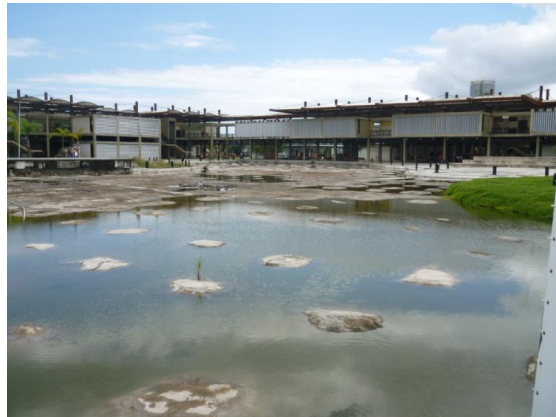
Fig. 88: Detalhe da ocorrência de recalques sofridos pela fundação no espelho d'água Ano: 2011. Acervo da autora
