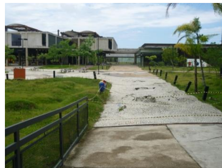
Fig. 86: Panorama parcial dos espaços livres da Escola de Ensino Médio SESC. Detalhe da ocorrência de recalques excessivos sofridos pela fundação em solos hidromórficos em sua pavimentação e canteiros, impedindo a circulação de pedestres. Ano: 2011. Acervo da autora.
