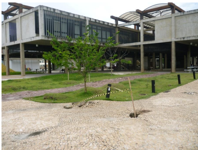
Fig. 85: Presenças de irregularidades na pavimentação e nos canteiros. Detalhe da presença de buracos na pavimentação e os balizadores de jardins inclinados. Ano: 2011. Acervo da autora.
