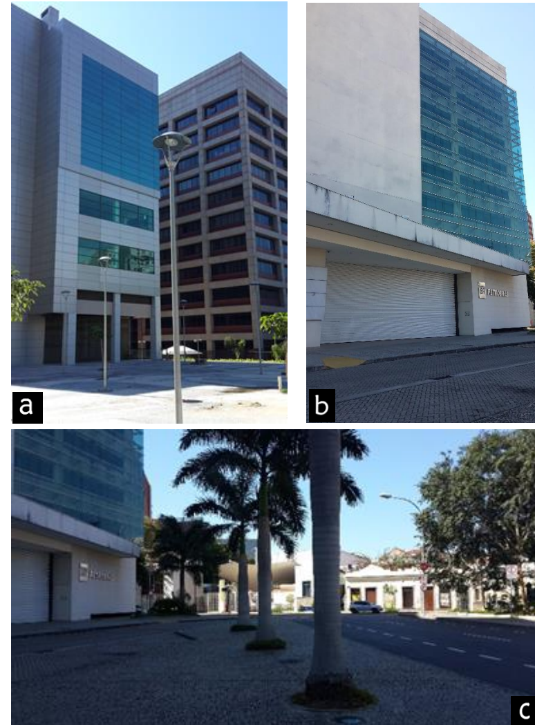
Figura 32. Deterioro de las edificaciones contemporáneas asociado a las calles vacías los fines de semana. Fotos VIVEROS, 2015
