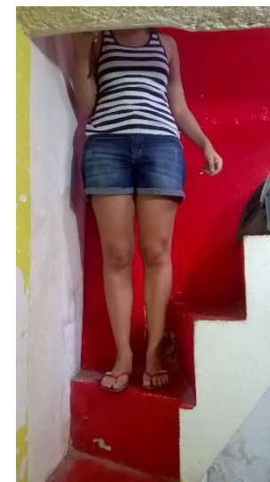
Figura 96: escada em uma das casas visitadas, mau dimensionamento de vãos e degraus. foto de Raizza Talon.
