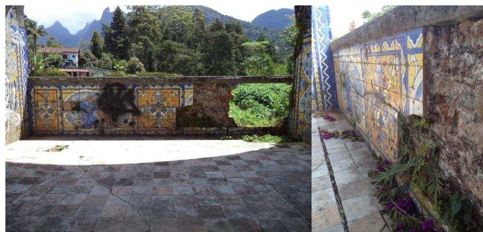
Figura 58 - Detalhe lacuna painel 06
