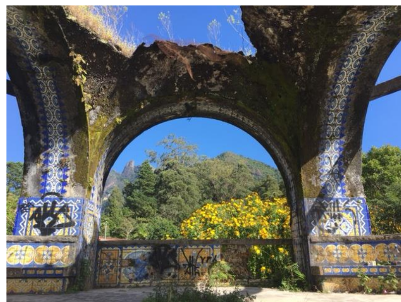
Figura 124 - Ausência da cobertura e forro em ruínas - Vista oeste Foto da autora em Janeiro/ 2017
