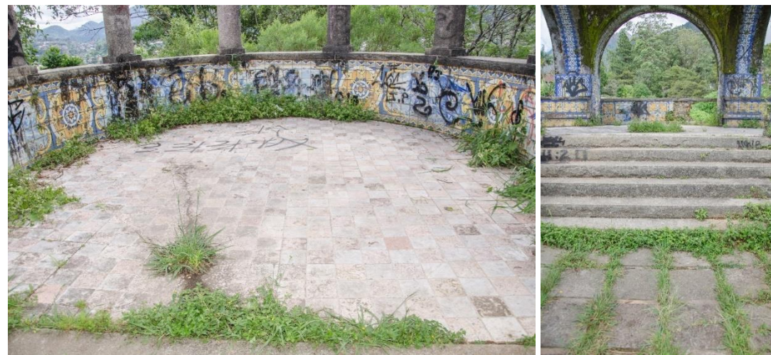
Figura 54 - Estado atual do piso
