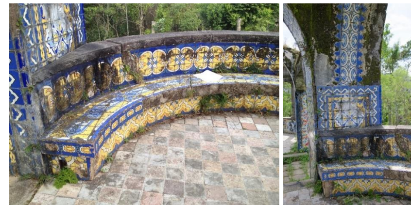
Figura 57 - Rachadura por recalque do terreno
