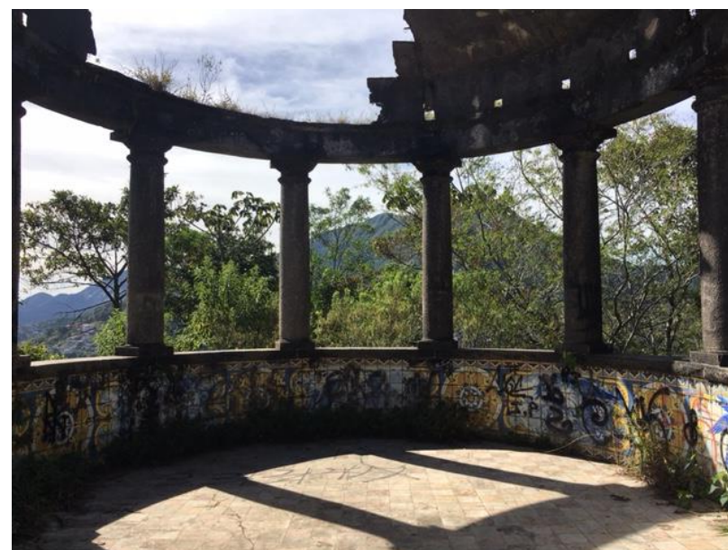
Figura 121 - Ausência da cobertura e forro em ruínas - Vista leste Foto da autora em Janeiro/ 2017
