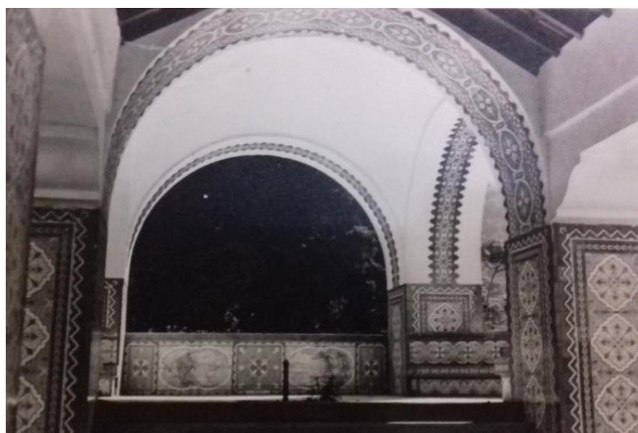
Figura 123 - Coberturas e forros originais - Vista oeste Foto sem data - Acervo Casa da Memória Arthur Dalmasso.
