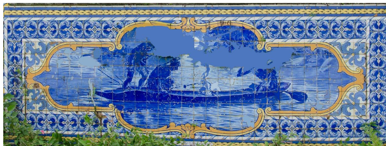
Figura 103 - Preenchimento das lacunas por abstração cromática - Painel 01
