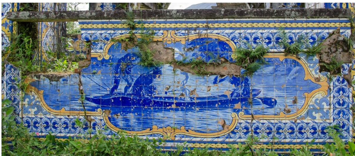
Figura 89 - Painel face oeste - maior lacuna. Foto da autora em Janeiro/ 2017.
