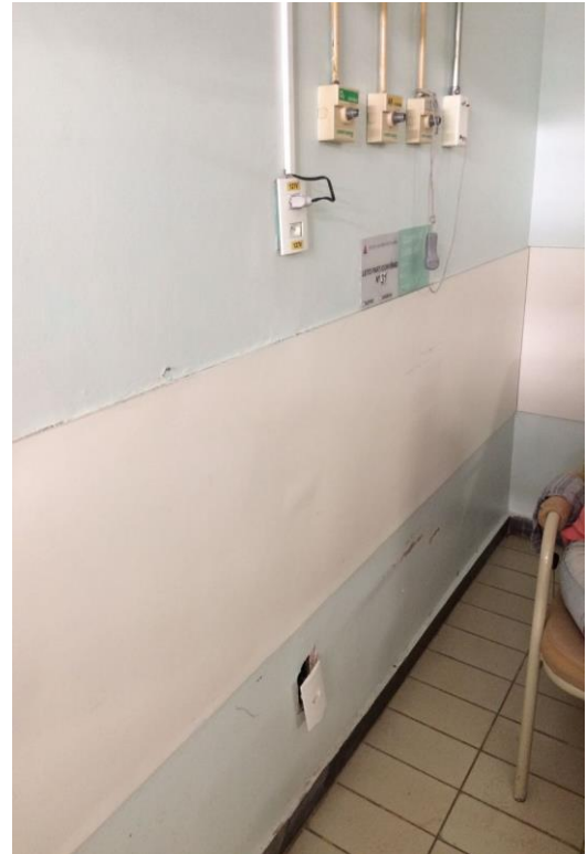
Figura 34: Rede elétrica deficitária Fonte: Acervo do autor, 2016.
