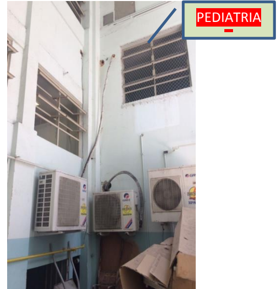
Figura 23: Foto do fuste de ventilação. Fonte: Acervo do autor, 2016.
