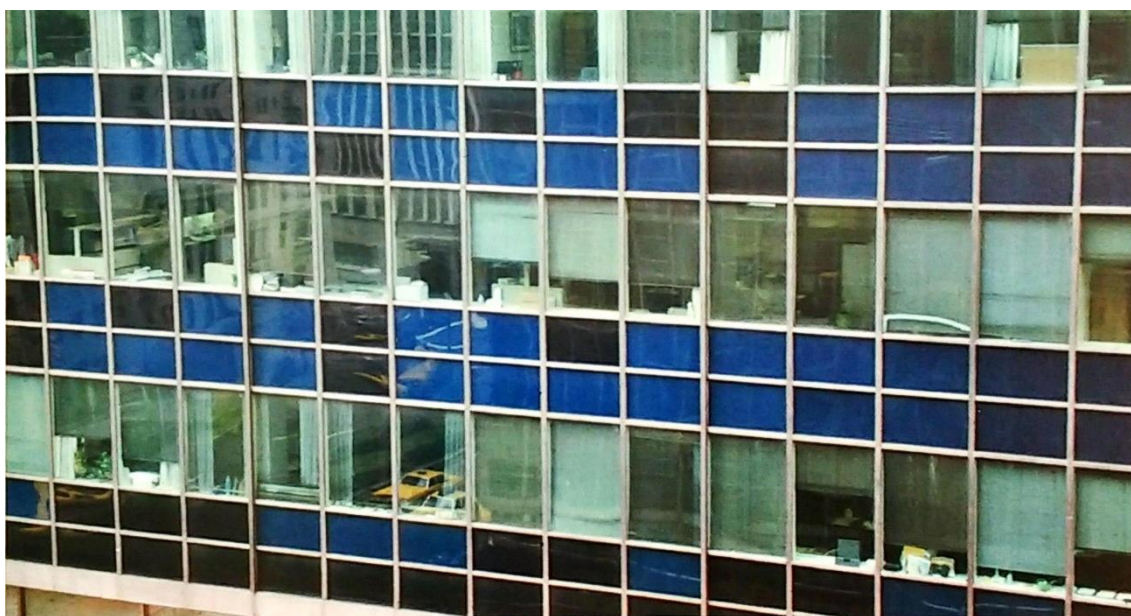
Figura 19 – Curtain wall (antes da restauração) do Lever House, Nova York. Fonte: PRUDON, 2008, imagem colorida 22.
