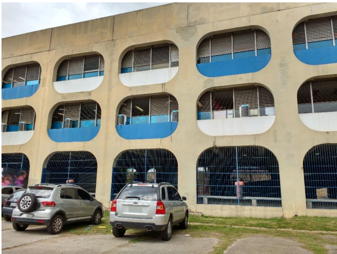
Figura 84 – Fachada do CIEP Henfil, Caju, com a presença de aparelhos de ar condicionado instalados de maneira desordenada. Foto: Silvino Marinho, 2017.
