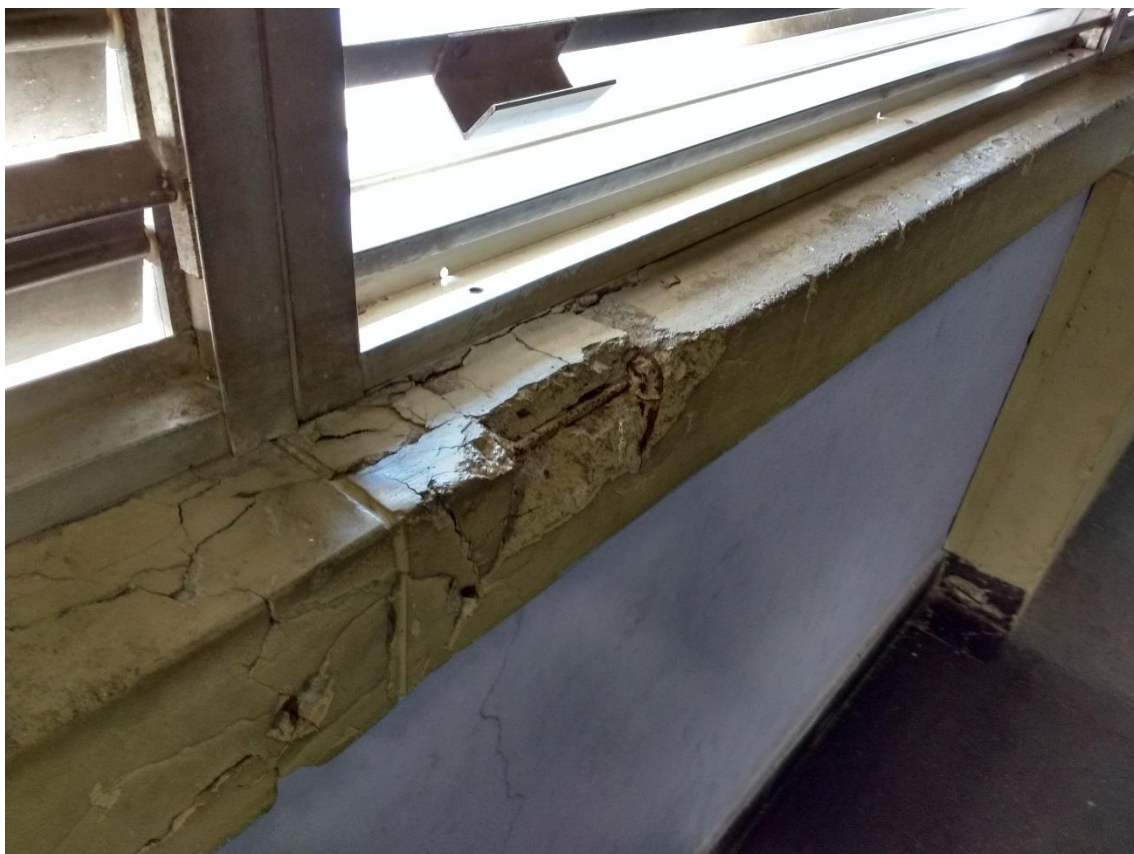
Figura 85 – Armadura exposta no CIEP Procópio Ferreira, Del Castilho. Foto: Silvino Marinho, 2017.
