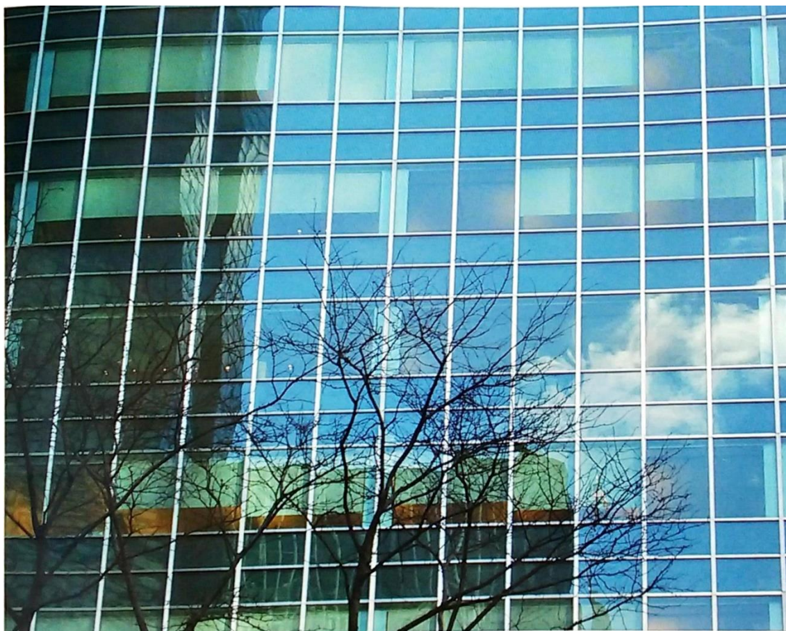
Figura 20 – Curtain wall (após restauração) do Lever House, Nova York. Fonte: PRUDON, 2008, imagem colorida 23.
