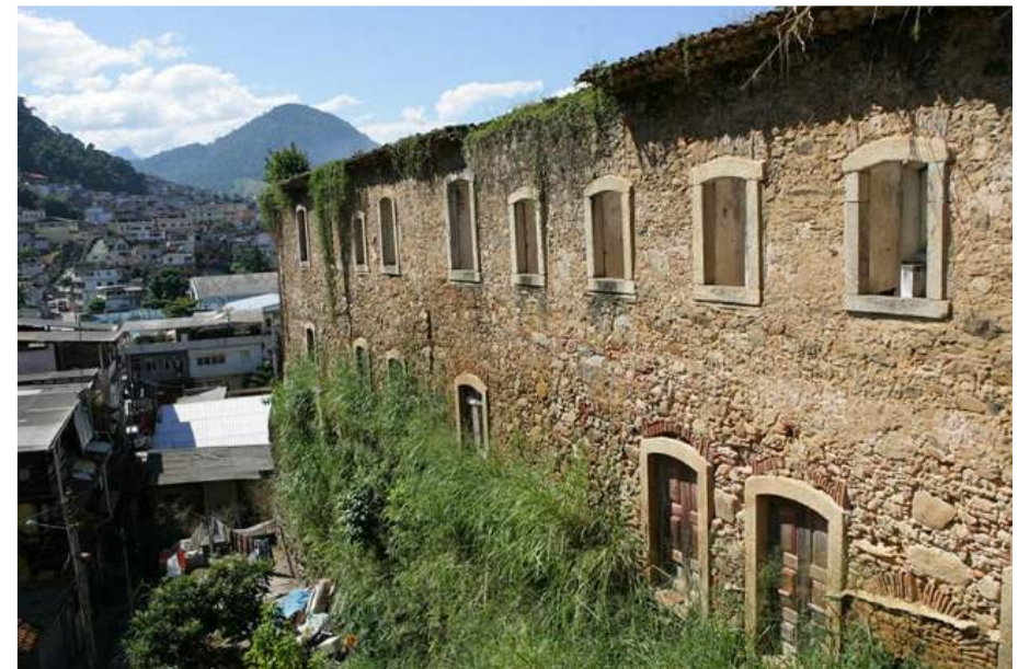
Figura 53 - Embasamento do aqueduto tomado pelo Capim Colonião. Fonte: site IPHAN, sem data.
