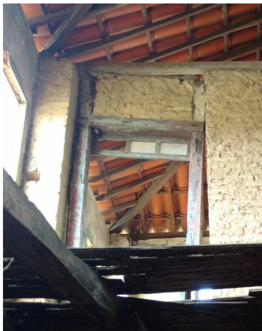
Figura 38 - Deformação das paredes e vãos. Fonte: Fotografia da autora, 2016.
