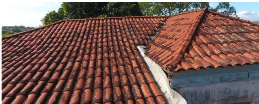
Figura 50 - Rincão na fachada Oeste-Sudoeste com acabamento inadequado devido à remoção da parede interna. Fonte: Fotografia da autora, 2017.
