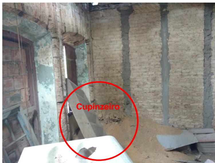
Figura 43 - Presença de cupinzeiro no interior do primeiro cômodo contíguo à fachada principal.
