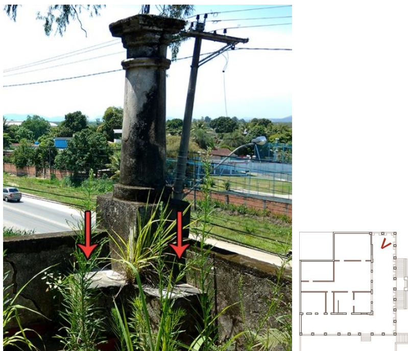
Figura 25 - Coluna em quina da fachada principal indicando as peças de mármore ainda presentes nas partes mais inferiores das colunas. Fonte: Edição sobre fotografia da autora, 2017.
