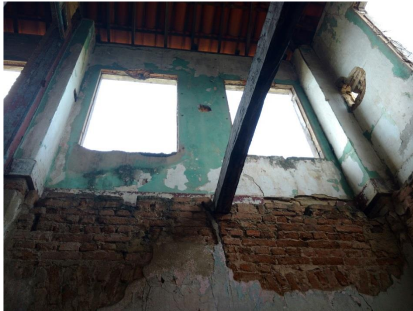
Figura 42 - Revestimentos inadequados são observados ao longo de toda a edificação, bem como ausência de alvenarias e outros elementos como pisos e forros. Fonte: Fotografia da autora, 2016.
