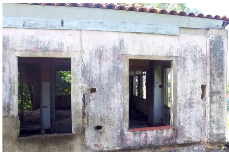
Figura 70 - Rachaduras em uma das fachadas, e parede posterior desabada vista pela janela. Fonte: Fotografia da autora, 2017.
