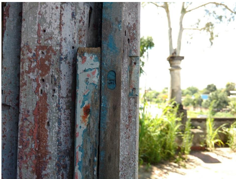
Figura 63 - Furos feitos para revoadas e ventilação de cupins na madeira. Fonte: Fotografia da autora, 2016.
