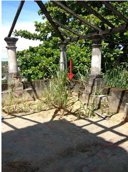
Figura 73 - Observa-se nesta imagem quina onde o piso apresenta uma depressão onde hoje existe uma camada de terra, onde observamos um grande formigueiro e vegetação. Bem como a presença de lajotas degradadas. Fonte: Fotografia da autora, 2016.
