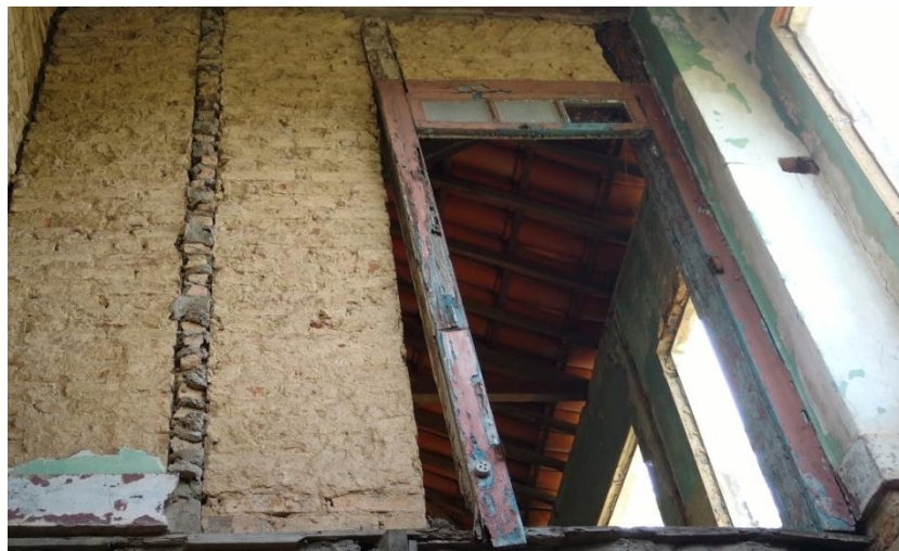
Figura 37 - Coluna de alvenaria feita com a presença de cimento. Fonte: Fotografia da autora, 2016.
