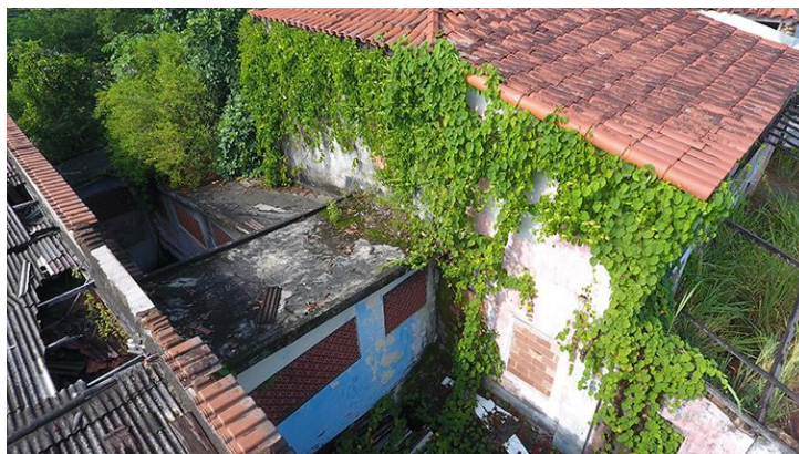
Figura 34 - Rampa de acesso entre o anexo e a antiga Sede, um dos elementos responsáveis pela descaracterização desta fachada. Fonte: Fotografia da autora, 2017.
