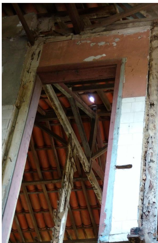
Figura 54 - Reforços improvisados no interior da edificação. Fonte: Fotografia da autora, 2017.
