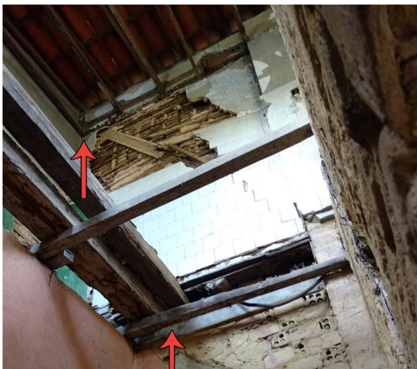
Figura 45 - Madeiramento restante dos frechais do teto do segundo pavimento, e forro do primeiro/piso do segundo. Fonte: Fotografia da autora, 2016.
