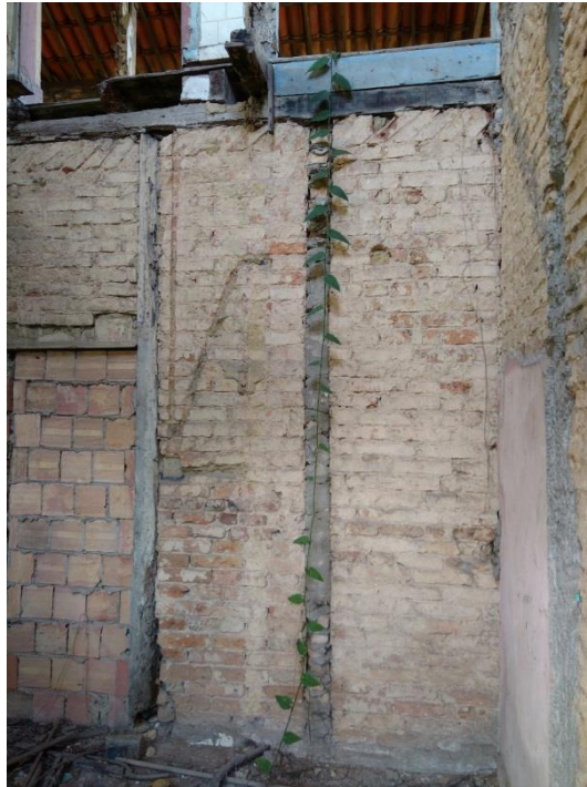
Figura 41 - Presença de vão emparedado, vegetação e o desabamento do assoalho do segundo pavimento / teto do primeiro pavimento. Fonte: Fotografia da autora, 2016.
