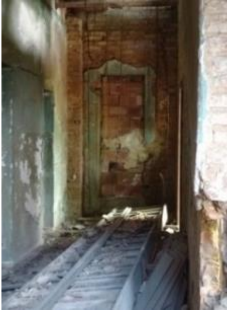
Figura 57 - Vão de porta emparedado na ligação interior da edificação Sede com o anexo hospitalar. Fonte: Fotografia da autora, 2016.
