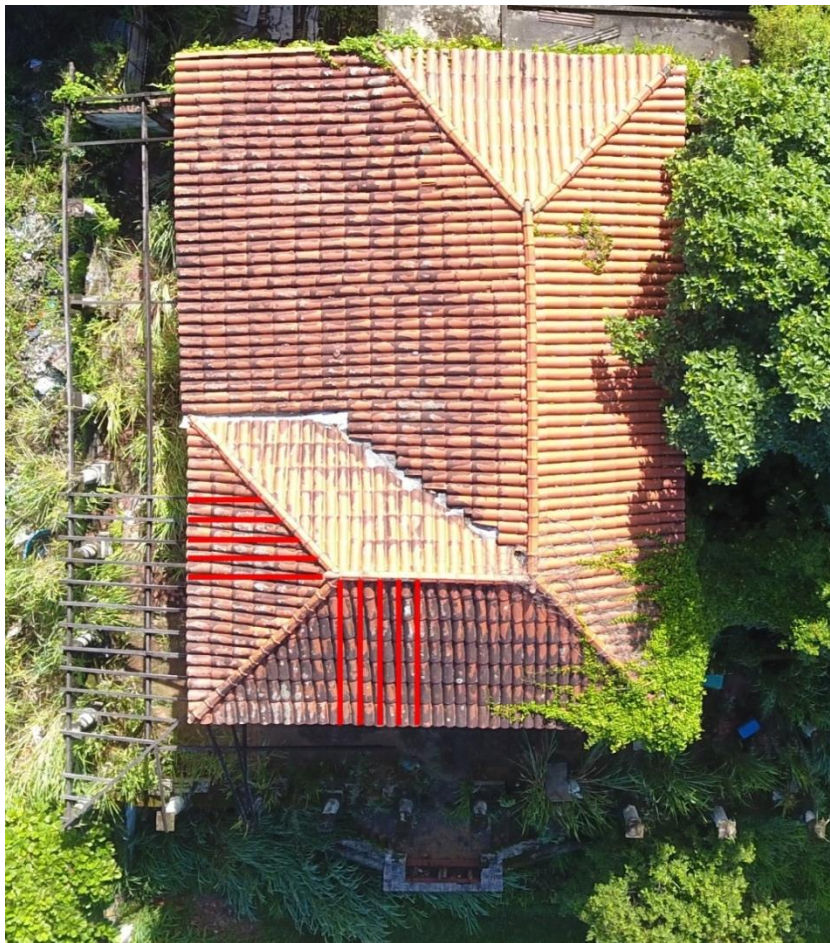
Figura 52 - Alteração do alinhamento do entelhamento. Fonte: Fotografia da autora, 2017.
