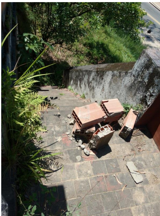
Figura 74 - Guarda-corpo rústico da escada de acesso, com presença de manchas de umidade e agentes biológicos. Fonte: Fotografia da autora, 2016.
