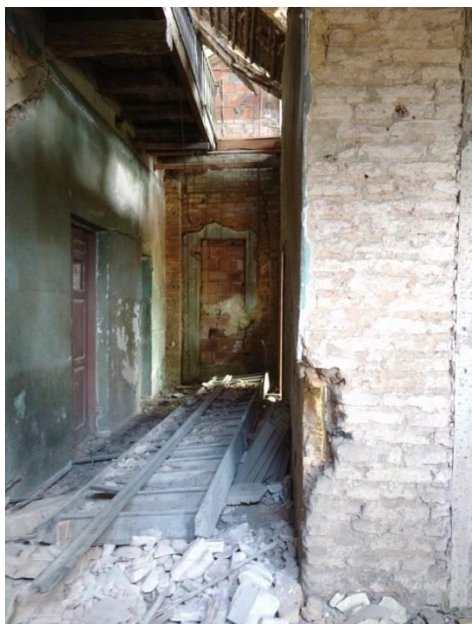
Figura 48 - Escada de madeira desabada no interior do edifício. Fonte: Fotografia da autora, 2016.
