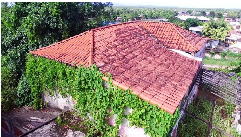
Figura 89 - Fachada 3, descaracterizada pela conexão com o anexo e com seus vãos emparedados. Fonte: Fotografia da autora, 2017.
