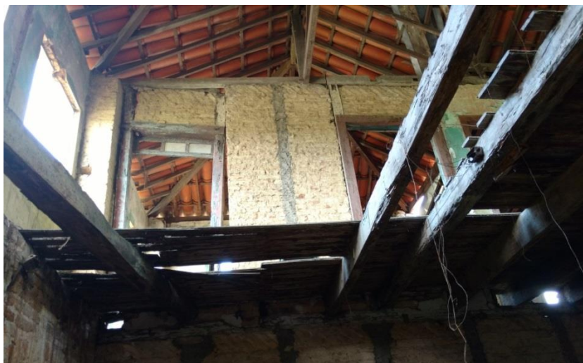
Figura 46 - Madeiramento remanescente do forro do primeiro pavimento/piso do segundo. Fonte: Fotografia da autora, 2016.
