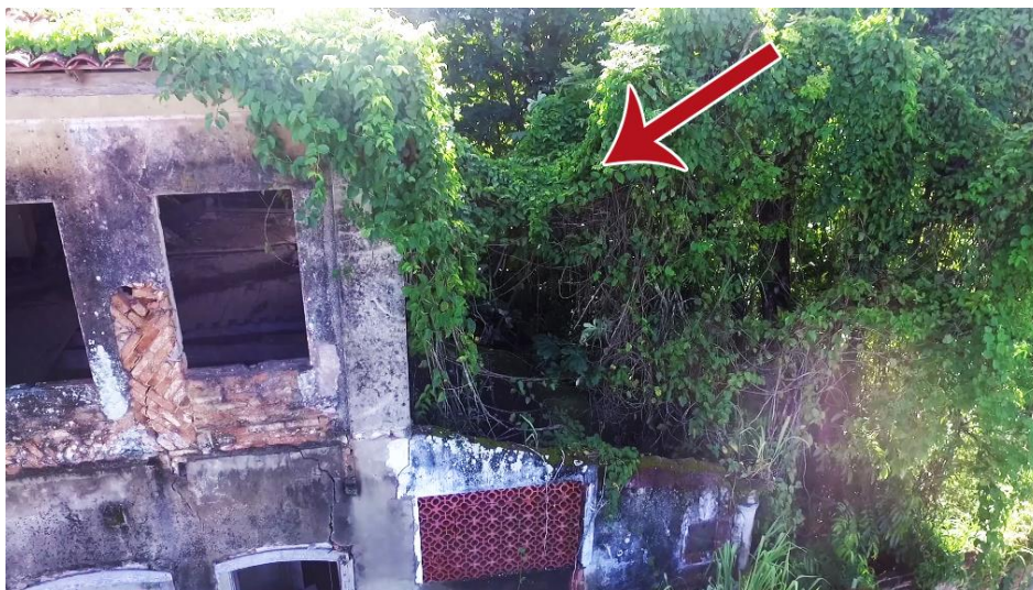
Figura 90 - Fachada 4, inacessível, observa-se o desabamento de parte de sua estrutura a partir do interior. Fonte: Fotografia da autora, 2017.
