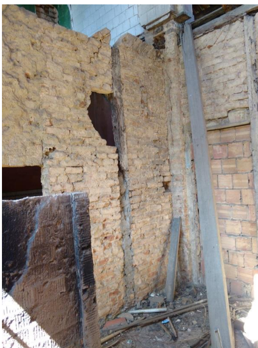
Figura 40 - Variedade de diferentes tipos de tijolos presentes na edificação. Nota-se maior degradação das vedações mais antigas, com os tijolos maciços e as madeiras apodrecidas. Fonte: Fotografia da autora, 2016.
