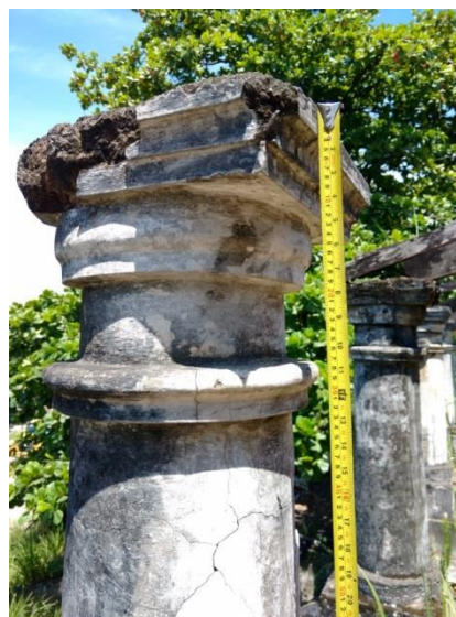
Figura 72 - Lacunas existentes em alguns dos capitéis e danificação da pintura e argamassa pela exposição excessiva ao sol e umidade. Fonte: Fotografia da autora, 2017.
