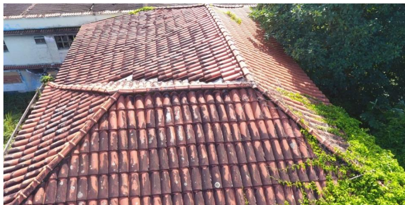
Figura 53 - Presença de Vegetação no telhado. Fonte: Fotografia da autora, 2017.
