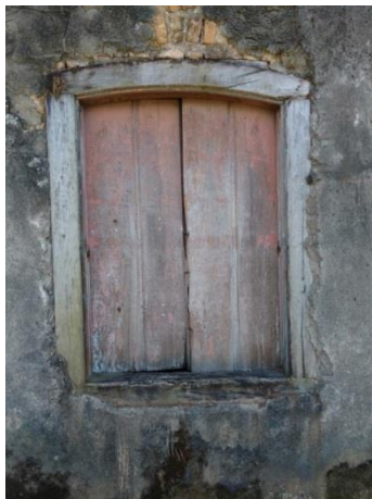
Figura 59 - Esquadria degradada devido à
