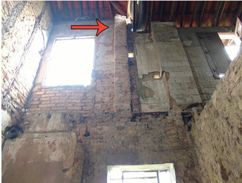
Figura 51 - Parede interna interrompida localizada na diferença de altura da cobertura. Fonte: Edição sobre fotografia da autora, 2016.
