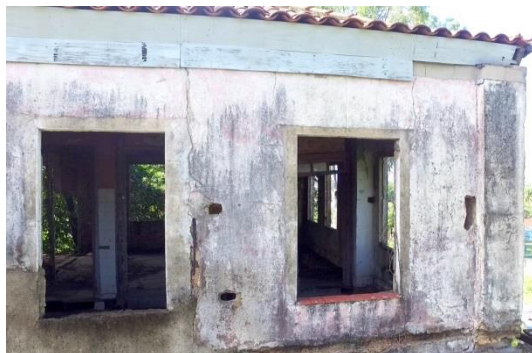
Figura 55 - Ausência das esquadrias. Fonte: Fotografia da autora, 2017.
