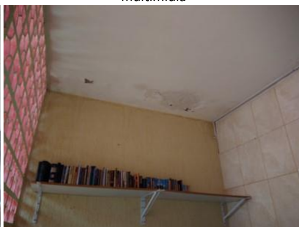
Figura 129 – Patologia construtiva sala de multimídia
