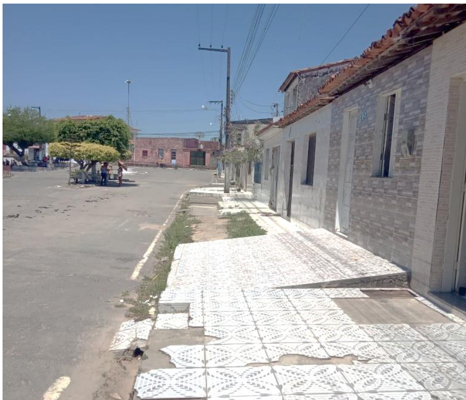
Figura 41- Passeios públicos irregulares em Santo Amaro das Brotas Fonte: Autora, 2019.
