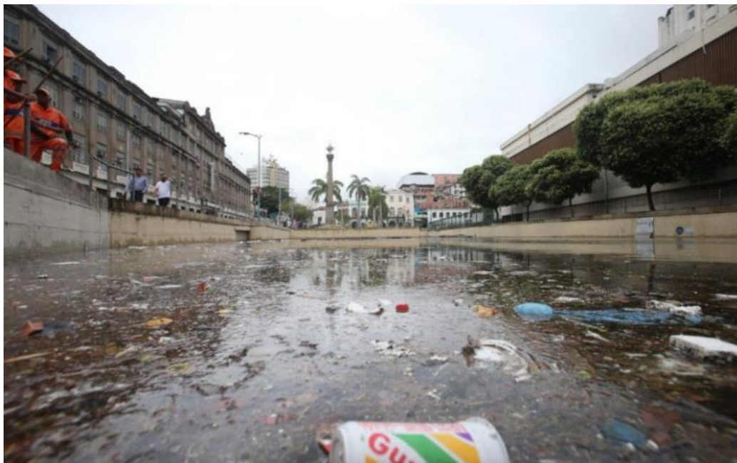
Figura 108 - Cais do Valongo inundado por falta de manutenção. Foto: Cleber Mendes / Agência O Dia
