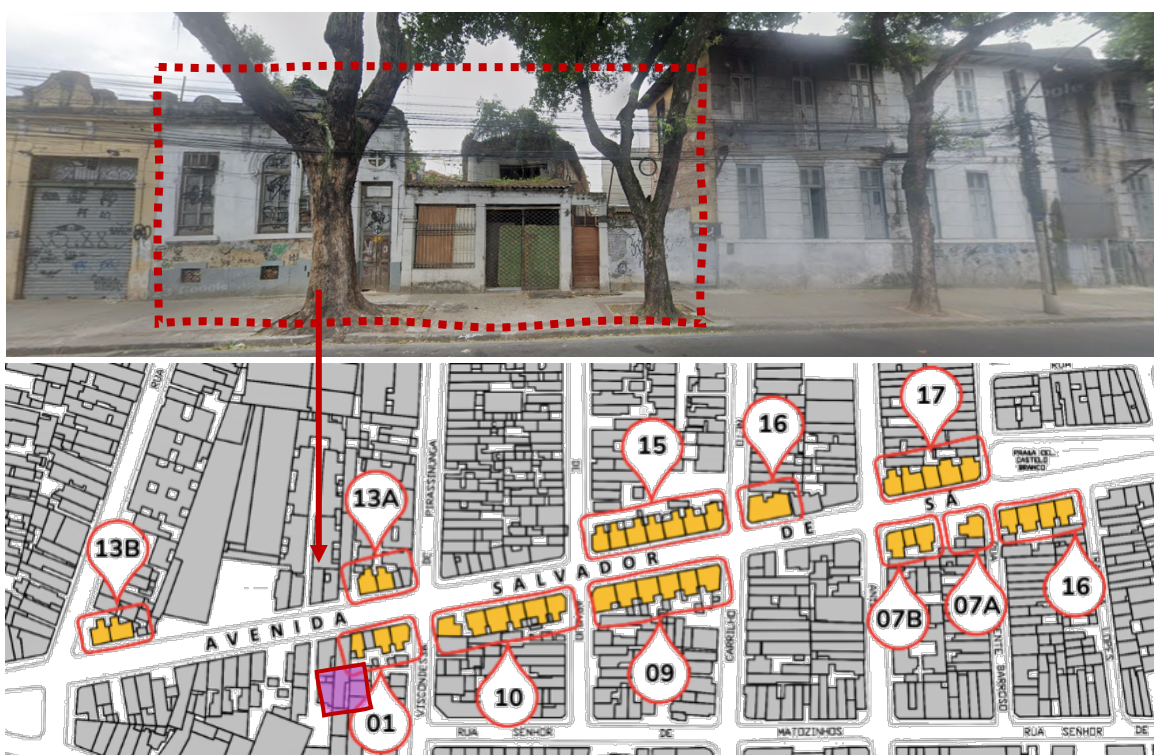
Figura 93: Edificações arruinadas n. 176 e n. 178 na Avenida Salvador de Sá e mapa com a localização em relação às quadras da VOSS. (do n.178 resta apenas a fachada)
