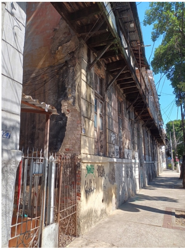
Figura 57: Fachada da quadra 09 com deterioração do revestimento e diferentes cores entre as pinturas dos blocos
