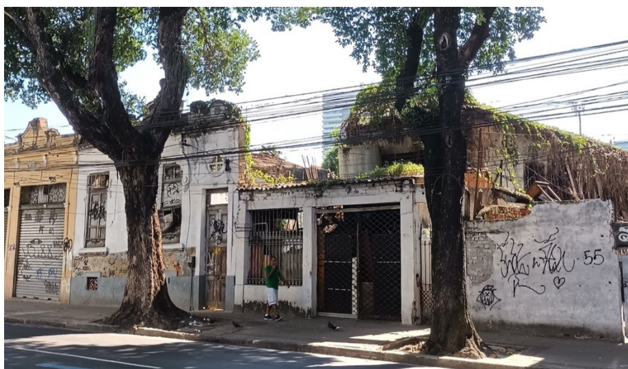
Figura 13: Edificações arruinadas 176 e 178 na Avenida Salvador de Sá
