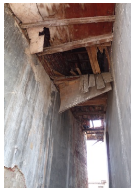
8. Forro de madeira danificado, apodrecido
