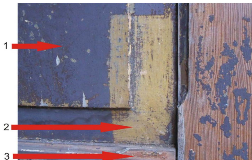
Figura 61: Pontos investigados Figuras 04 e 04A (Esquadrias: portas e janelas em madeira de pinho de riga)
