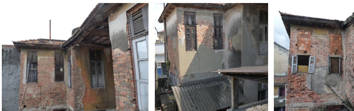
Figura 56: Fachadas dos fundos das quadras 01, 07 e 09 respectivamente, com revestimento deteriorado
