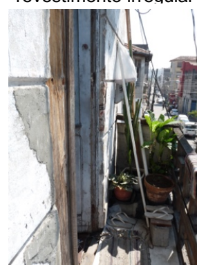
9. Argamassa de revestimento irregular
