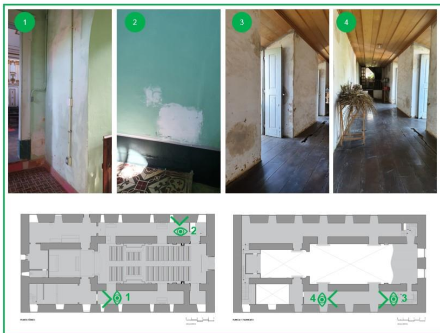
Figura 66: Identificação de danos nas argamassas internas. Fonte: Autora, 2022
