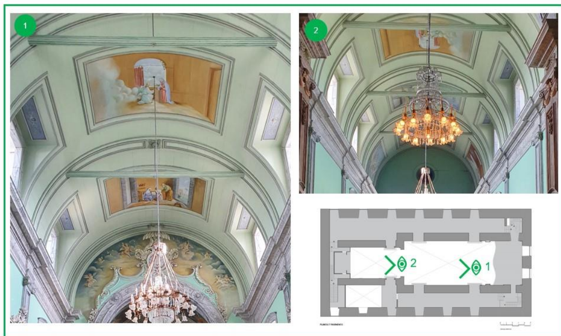
Figura 75: Identificação de elementos integrados no forro. Fonte: Autora, 2022
