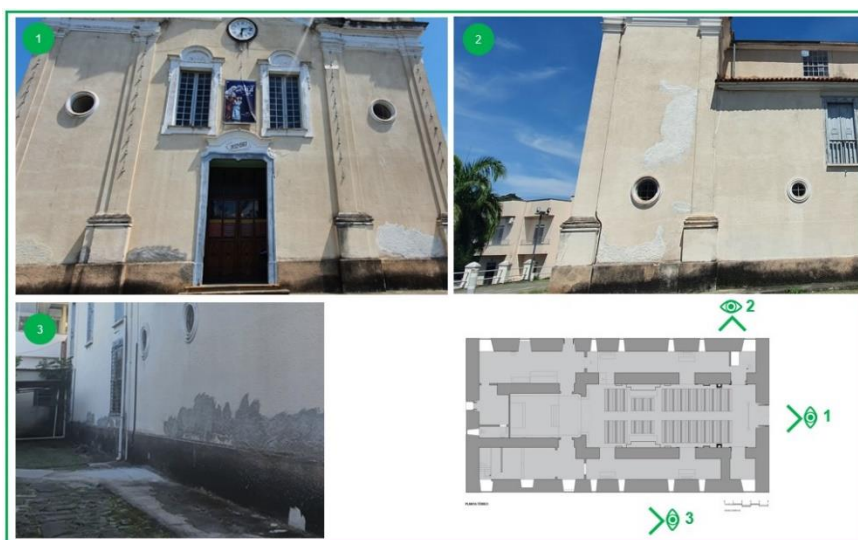
Figura 67: Identificação de danos nas argamassas externas. Fonte: Autora, 2022
