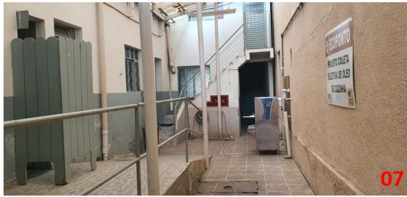
Fundos da Igreja Sant'Ana com construção inadequada
