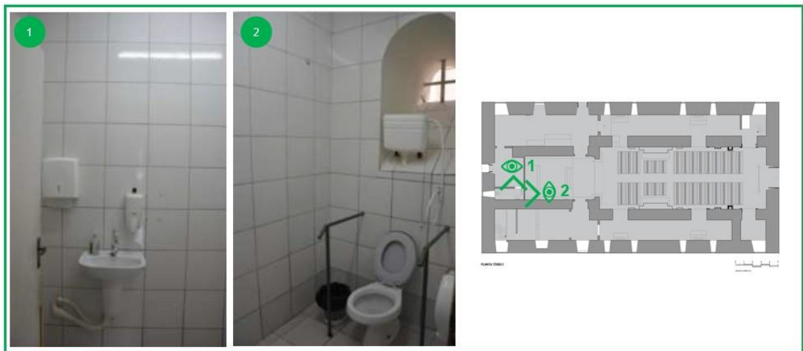
Figura 83: Identificação dos danos devido a intervenções irregulares. Fonte: Autora, 2022.
