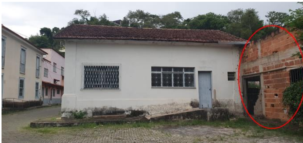
Figura 18: Edificação em obra para nova secretaria e banheiros anexos à “Casa Paroquial tombada”. Fonte: Autora, 2020
