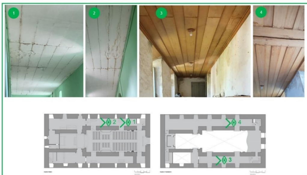
Figura 72: Identificação de danos no forro.
