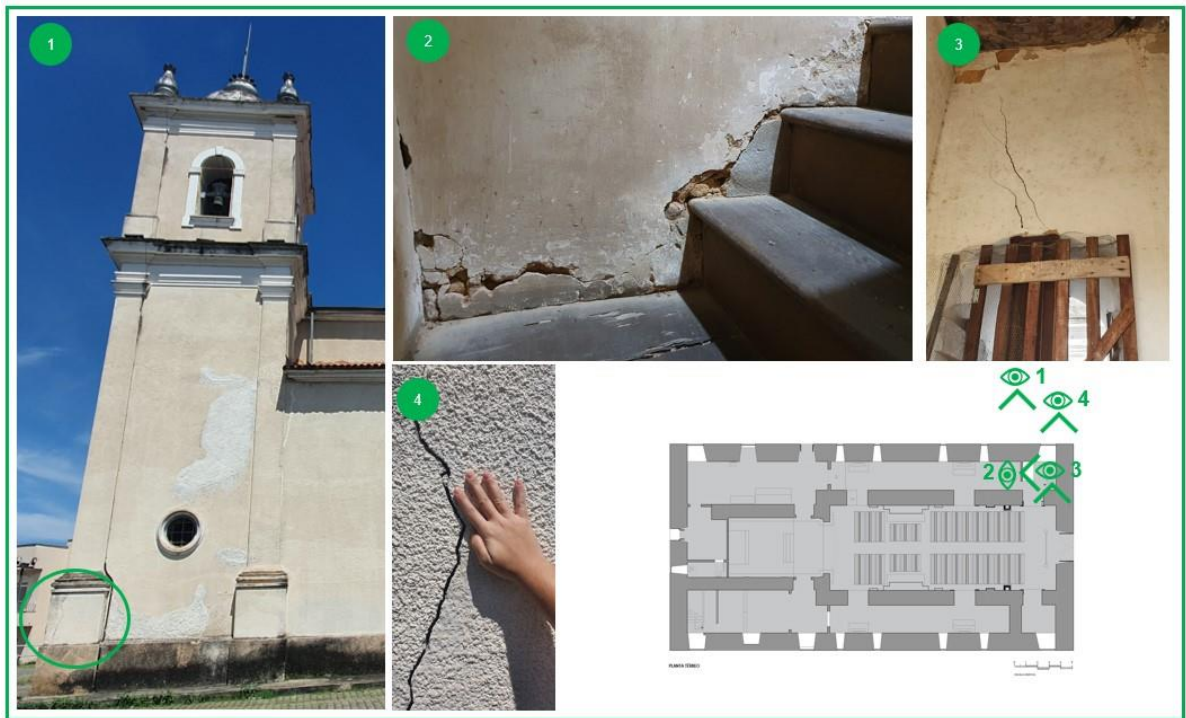
Figura 82: Identificação dos danos nos campanários. Fonte: Autora, 2022.
