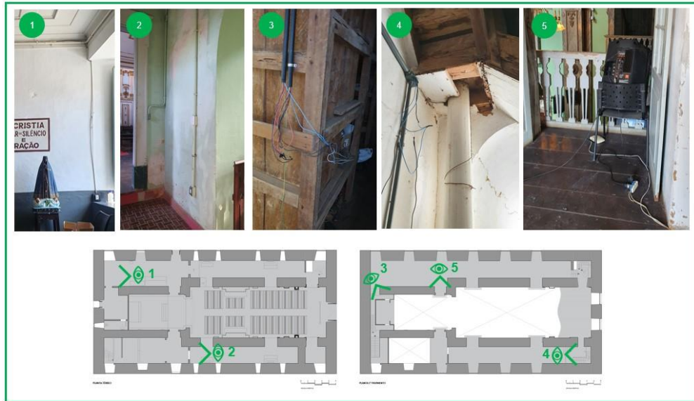
Figura 78: Identificação dos danos nas instalações prediais de elétrica. Fonte: Autora, 2022.
