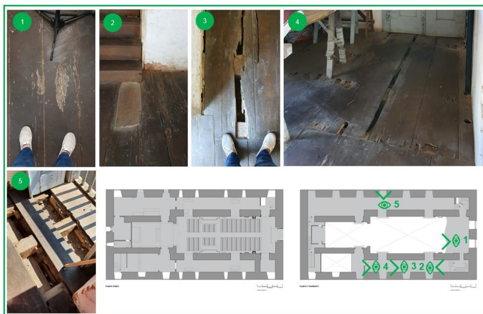
Figura 69: Identificação de danos nos pisos de madeira. Fonte: Autora, 2022
