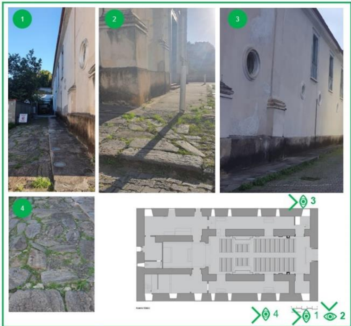
Figura 70: Identificação de danos na cantaria. Fonte: Autora, 2022
