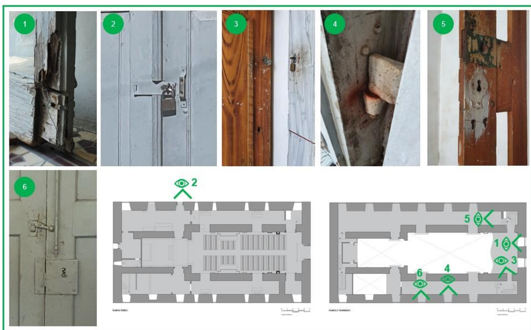
Figura 65: Identificação de danos nas ferragens. Fonte: Autora, 2022
