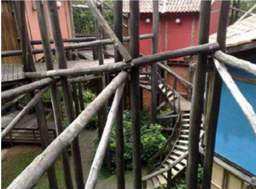
Figura 78. Detalhe da estrutura de madeira e da circulação por escada no interior do cilindro. Fonte: SILVA; TERIBELI, 2018, p. 133.
