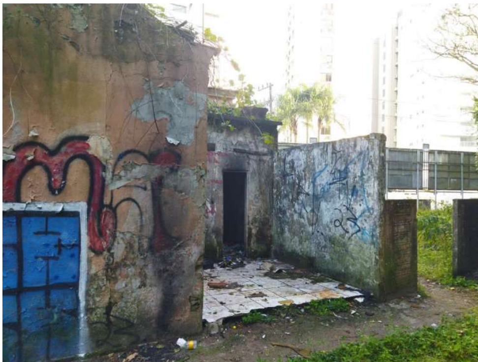
Figura 58. Anexo dos fundos - arruinamento da fachada e do sistema de cobertura.
