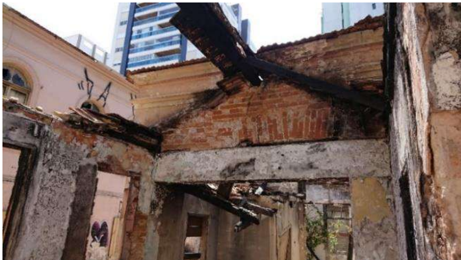
Figura 59. Anexo dos fundos - arruinamento do sistema de cobertura, do forro, do reboco e das esquadrias.
