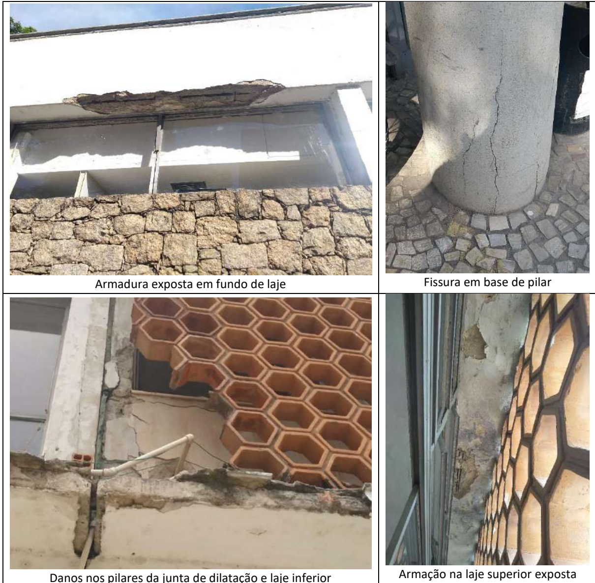
Quadro 18 - Danos em elementos estruturais. Fonte: fotos de Leonardo Santos, 2020.
