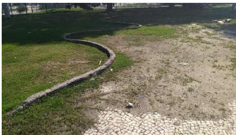
Figura 69 - Área com pavimentação danificada próximo ao ambulatório (B). Fonte: foto de Leonardo Santos, 2019.
