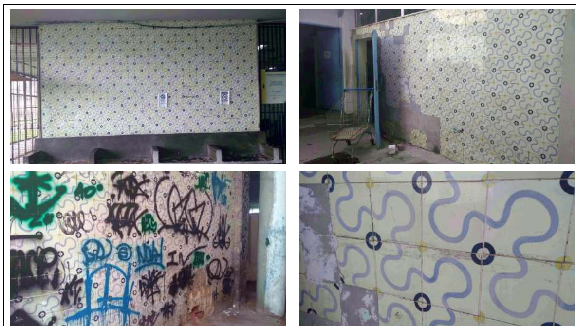
Quadro 27 - Caracterização dos danos nos painéis de azulejos cerâmicos. Fonte: acervo COPRIT-ETU, 2019.
