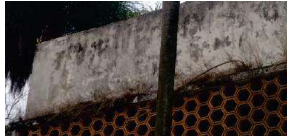
Alvenaria danificada por infiltrações
