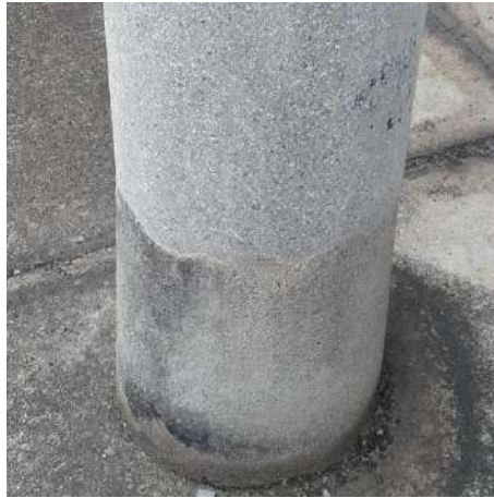
Figura 114 - Pilar indevidamente recuperado. Fonte: foto de Leonardo Santos, 2019.
