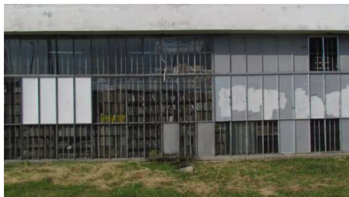
Figura 72 - Esquadrias danificadas por depredação no térreo. Fonte: foto de Laura Curvão, 2021.
