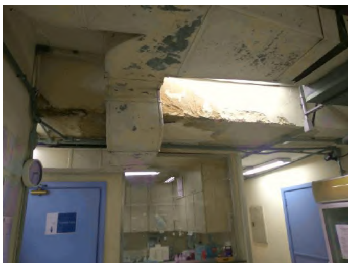
Figura 88 - Infiltrações na sala de preparações da Farmácia. Fonte: foto de Leonardo Santos, 2020.
