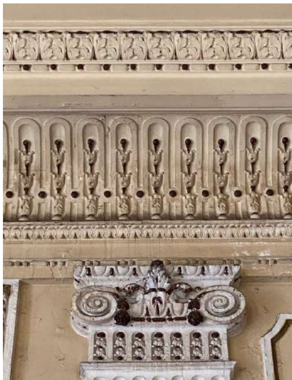
Figura 107: Sujidades detectadas nos bens integrados do Salão Raymundo
