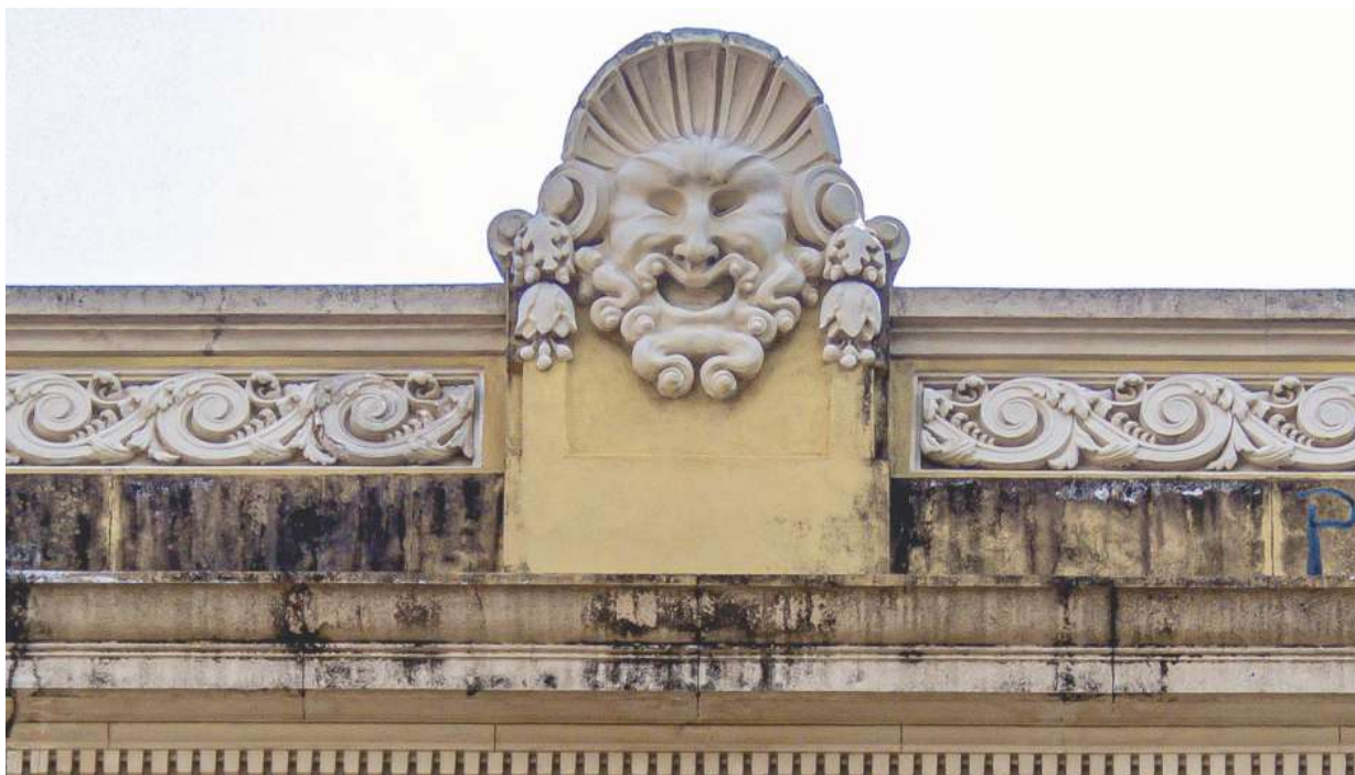
Figura 106: Sujidades com manchas escorridas na Fachada da Escola de
