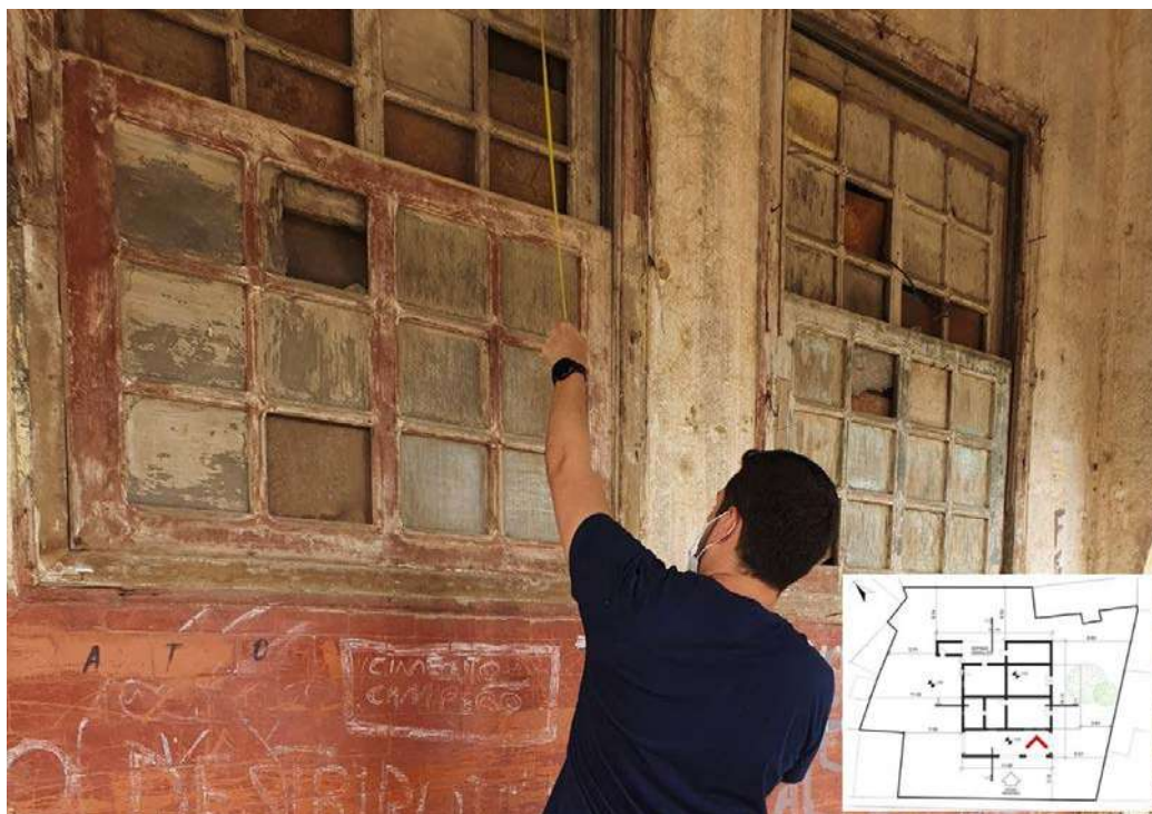
Figura 85: Esquadrias originais altamente degradadas. Fonte: Foto do autor. setembro de 2021.
