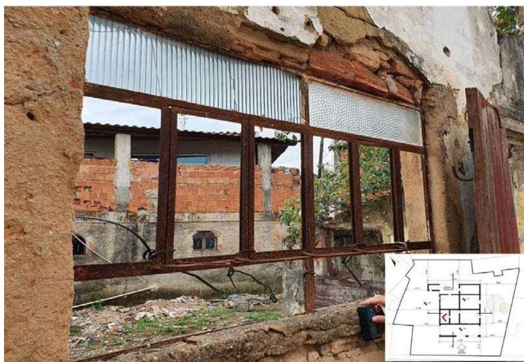
Figura 86: Janelas aparentemente não originais. Fonte: Foto do autor. setembro de 2021.
