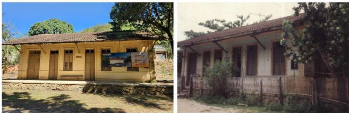
Figura 47: (a) A estação Rio D'ouro atualmente. (Fonte: Foto do autor. Setembro de 2023) (b) A estação Rio D'Ouro em 1988 já em estado de abandono. (Fonte: Acervo INEPAC)
