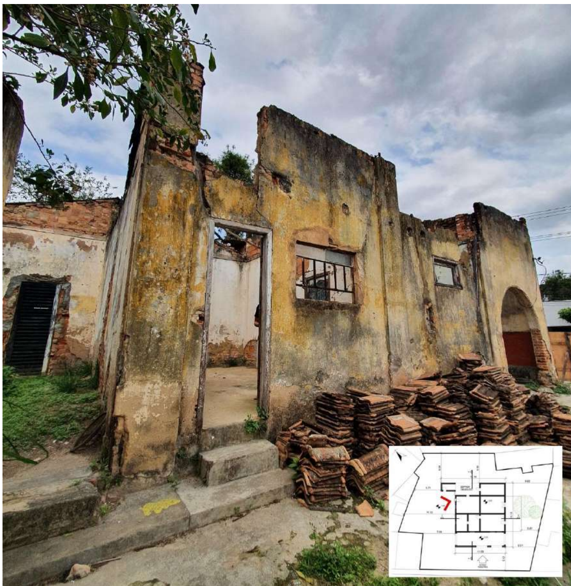
Figura 82: Vista Lateral da estação com paredes e coberturas bastante danificadas. Fonte: Foto do autor. Setembro de 2021.
