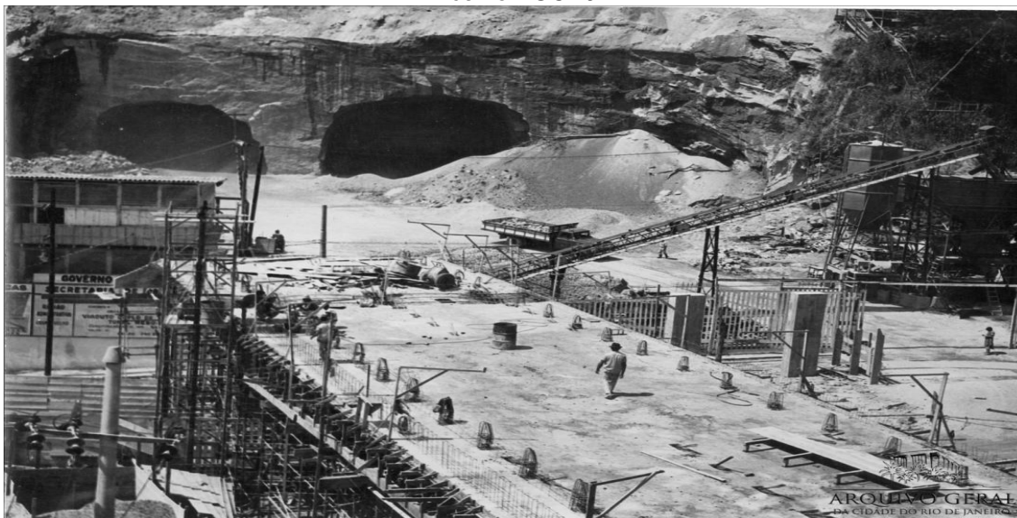
Figura 31 - Túnel Rebouças, s/d. Rio de Janeiro, RJ / Secretaria de Obras Públicas Acervo AGCRJ
