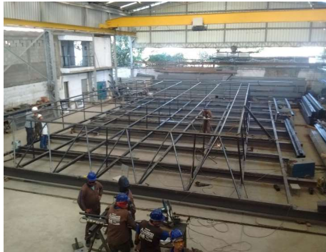
Figura 16: Aspecto geral da fábrica onde se realiza a montagem da treliça antes de ser transportada para o canteiro.
