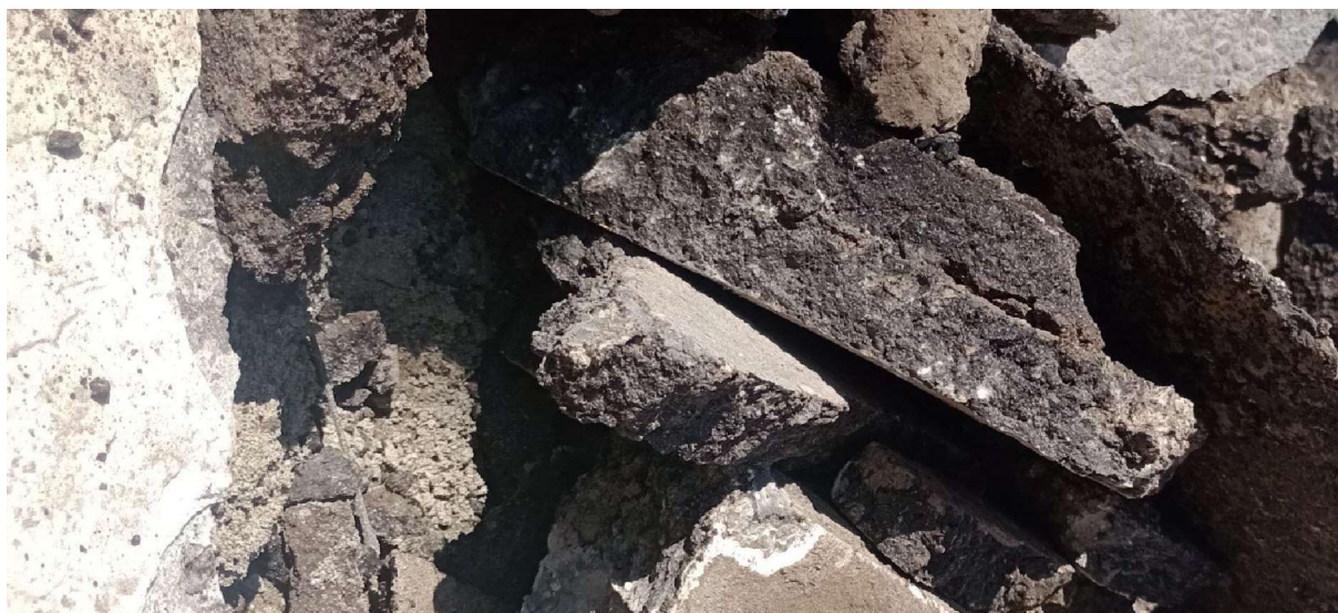
Figura 42. Asfalto rachado. Fonte: acervo pessoal
