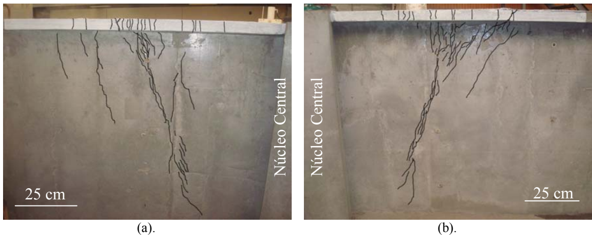
Figura 8.41 – (a) Fissuração observada na alma lado 01 e (b) Fissuração observada na alma lado 02.
