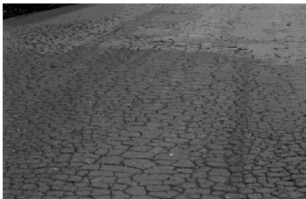
Figura 39- Semelhança entre um filme de asfaltenos(principal componente para fragilidade e formação de trincas) e as trincas do asfalto na pavimentação
