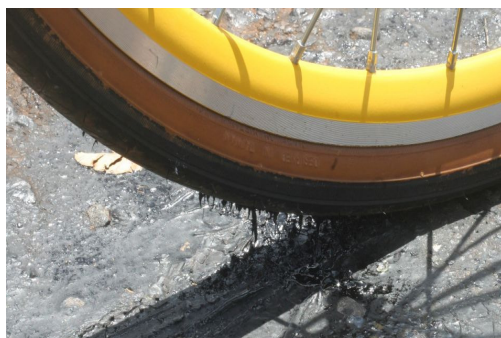
Figura 52 – Derretimento do asfalto de rodovias causado por excesso de ligante
