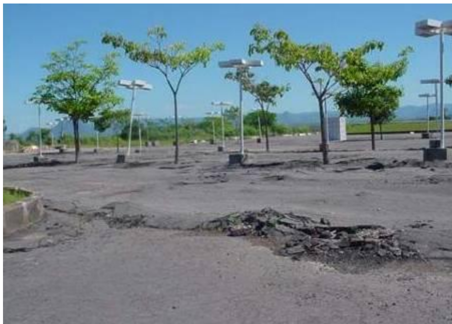
Figura 20: Exemplos de grandes deformações e trincamentos longitudinais em revestimento com escória expansiva (RODRIGUES, 2007).
