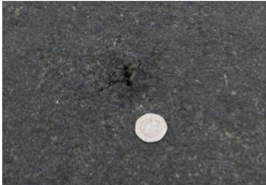
Figura 19: Exemplo de danos ao pavimento com escória expansiva (pé de galinha) (JONES, 2006).
