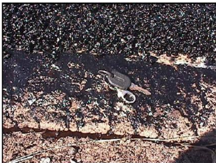
Figura 13: Escorrimento de ligante ocorrido durante a compactação da massa asfáltica devido a seu alto teor (SILVA, 2005).
