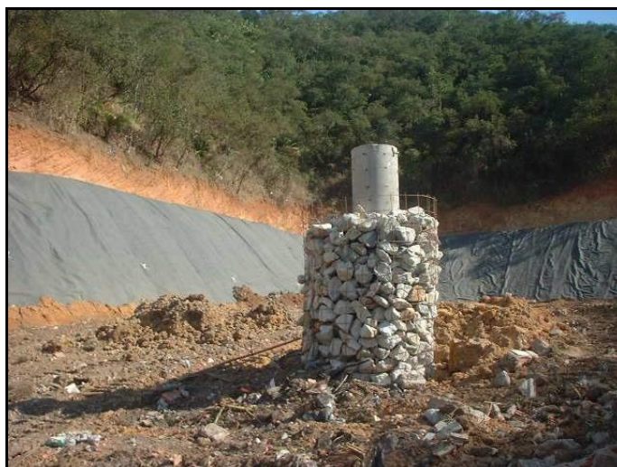
Figura 3.6: Dreno vertical de biogás do aterro da CTR Nova Iguaçu.
