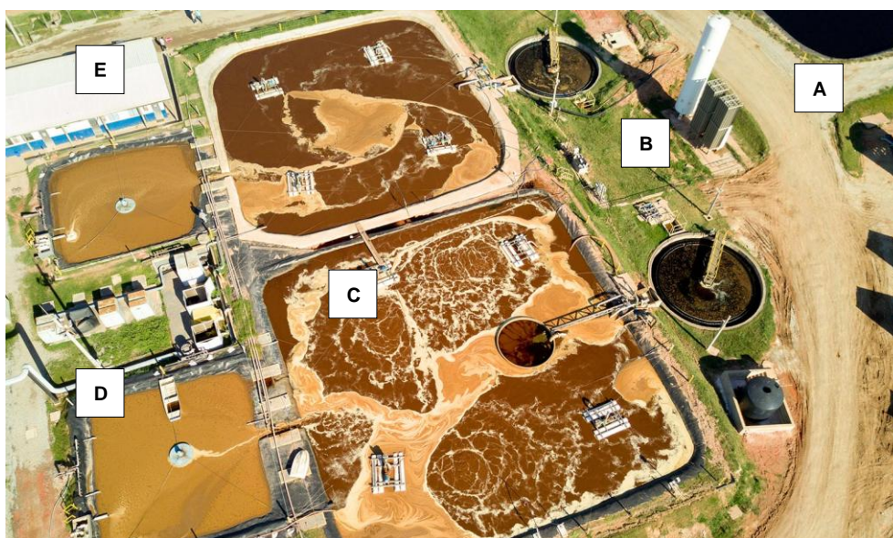
Figura 7 Imagem aérea da Estação de Tratamento de Chorume do aterro sanitário de Seropédica (RJ) (A: Lagoa de evaporação; B: Tratamento físico-químico; C: Tanque aeróbio; D: Tanque anóxico; E: Galpão com módulos de membranas).
