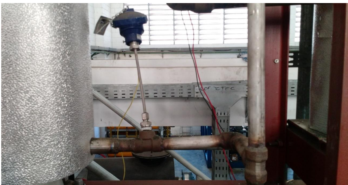
Figura 4.10. PPF-FG-1: entrada 2" de ar comprimido frio na base do aquecedor com sensor de temperatura (TT-01) enquadrado.
