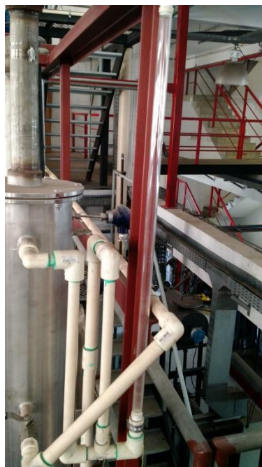
Figura 4.8. PPF-FG-1: tubulações de água e indicador de nível do vaso de lavagem de gás exausto. Incluso o tubo de inox 2" no topo por onde sai o gás final frio para a atmosfera
