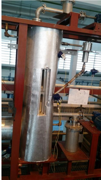
Figura 4.20. PPF-FGD-5: FBR-DI com seu duplo isolamento. Acoplamento à esquerda do aquecedor de ar horizontal e à direita o ciclone de topo, a rosca de retirada de R-FGD de fundo com o vaso de tratamento e termopares do FBR-DI.
