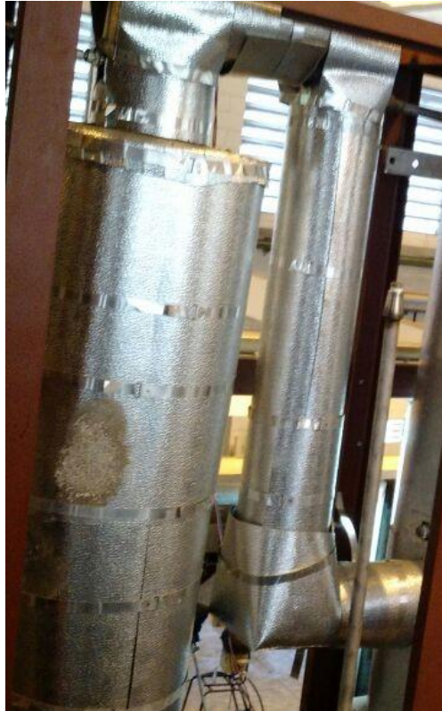
Figura 4.15. PPF-FGD-2: implementação de novas jaquetas de isolamento térmico com lã de vidro no aquecedor de ar e na linha de 2" aquecedor-FBR.
