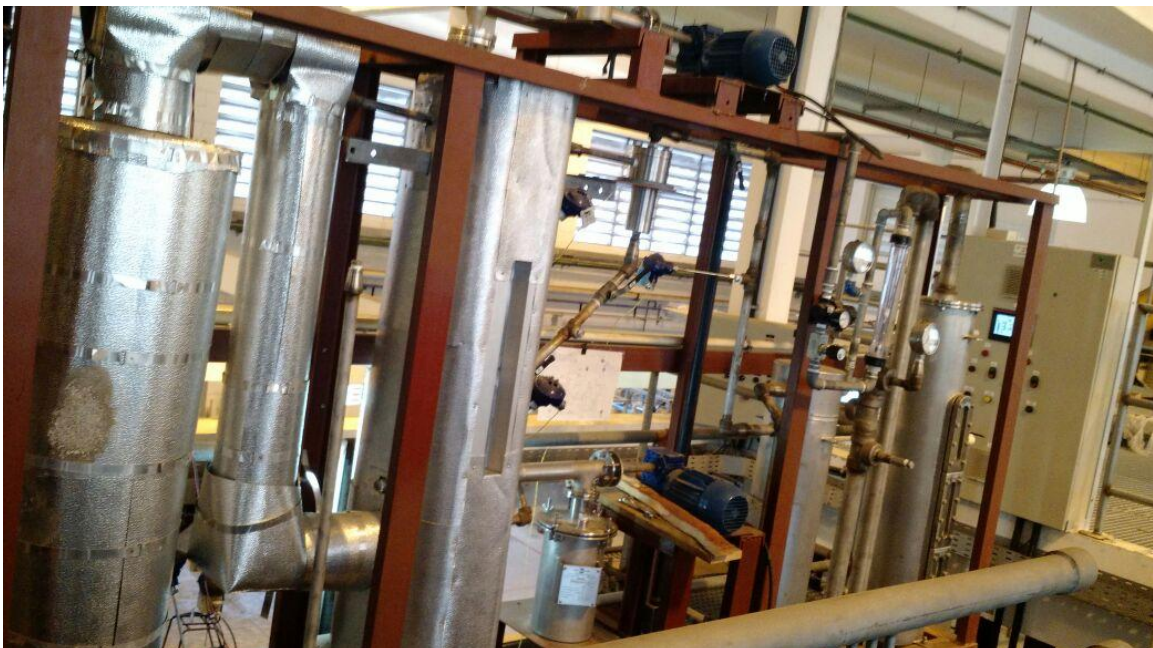
Figura 4.16. PPF-FGD-2: PPF-FGD-2 após implementação de novas jaquetas de isolamento com lã de vidro no aquecedor de ar e na linha 2" aquecedor-FBR.
