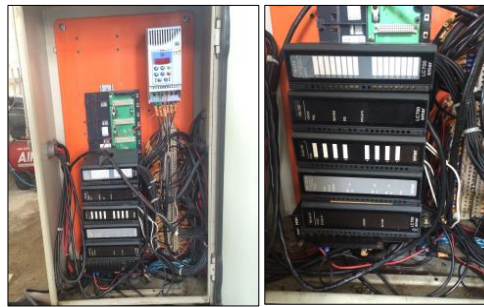
Figura 34 Montagem original do painel elétrico do CLP
