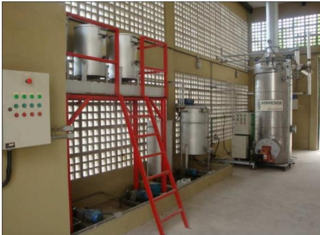
Figura 18 Central de utilidades do Laboratório de Engenharia Química da UFRJ
