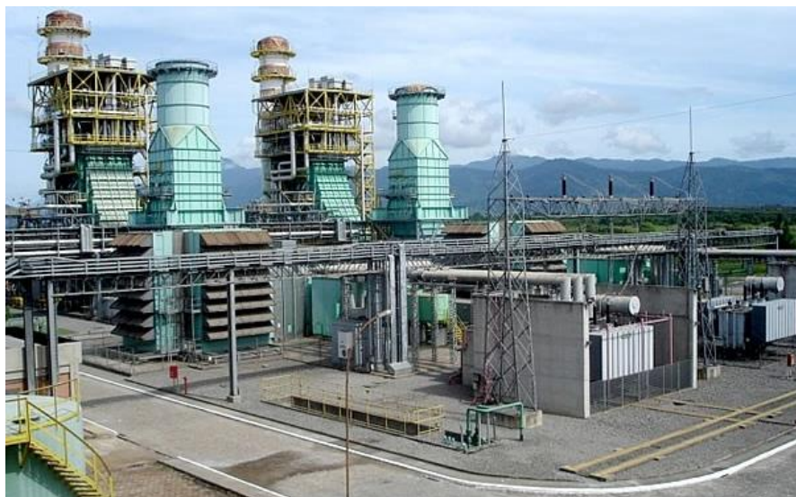
Figura 16 - Usina termelétrica de ciclo combinado – UTE Santa Cruz (Furnas, 2019).
