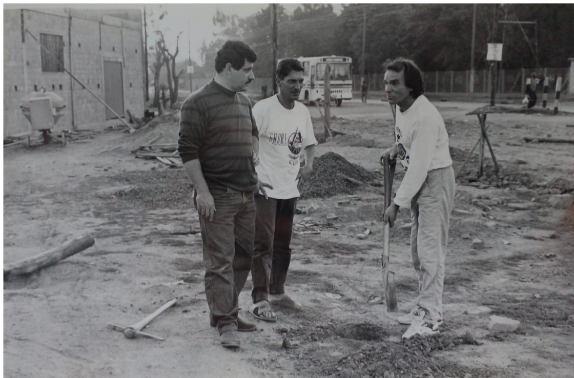
Imagem 12: Moradores cercando o terreno. Ao fundo, a avenida Padre Leopoldo Brentano e Escola Técnica Santo Inácio. Reprodução da foto retirada em 1993. Fotógrafo Vilmar da Rosa. Fonte: Associação de Moradores Castelo Branco.
