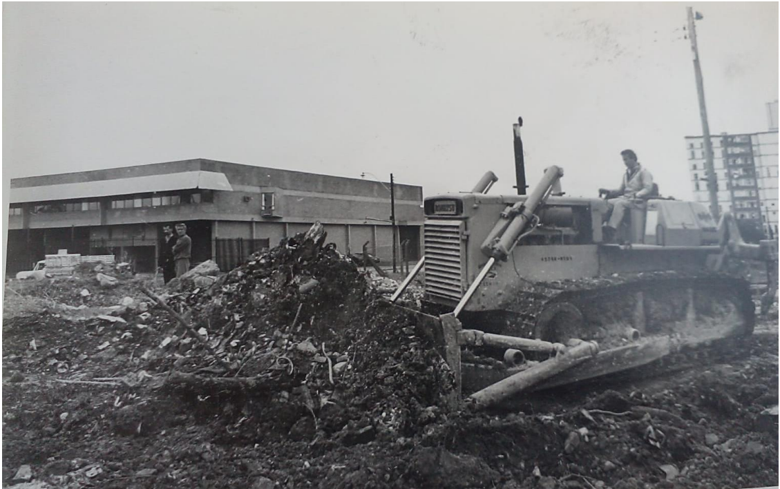
Imagem 9: Terraplanagem do terreno. Reprodução da foto retirada em 1993. Fotógrafo Vilmar da Rosa. Fonte: Associação de Moradores Castelo Branco.
